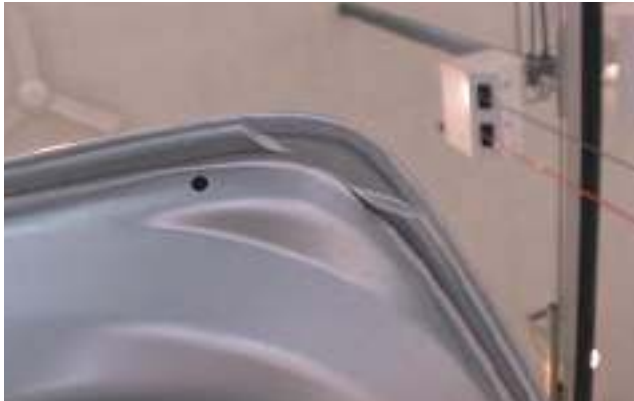
新車時トランクフードシーラント
